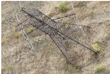
(b) Опора У-110
