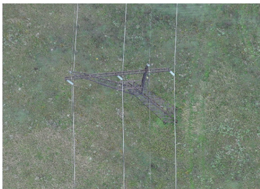
(a) Опора ВЛ-220
